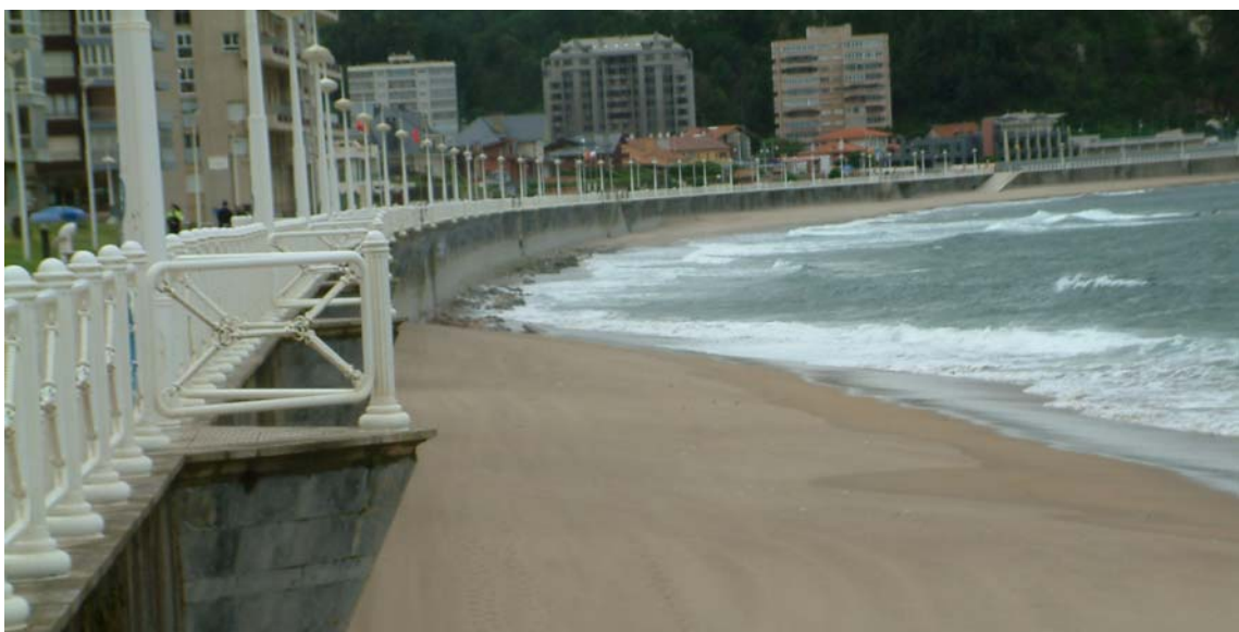
Lámina 4. A) Panorámica del paseo marítimo, en primer término, construido sobre el antiguo cordón dunar en los años sesenta del siglo pasado y, al fondo, el límite dunar con la playa, ligeramente retrasada hacia tierra. B) Detalle de la playa erosionando la base del paseo en una pleamar, debido a la pérdida de arena en un sector correspondiente a la cabecera de una corriente de resaca (“rip current”).
