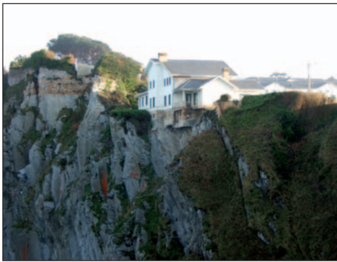
Figura 27 . Un magnífico ejemplo de la actividad erosiva en los acantilados lo encontramos en la localidad de Luarda, donde un chalet construido al borde del acantilado se encuentra en la actualidad parcialmente suspendido en el aire (imagen desde la carretera del puerto al cementerio de Luarda).
