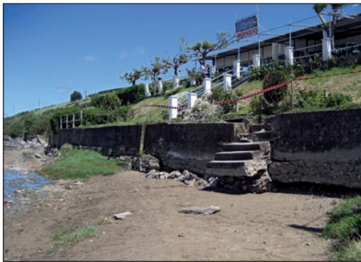
Figura 34. Invasión del dominio litoral: muro de contención construido por debajo del nivel de pleamar.
