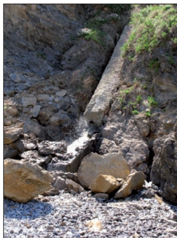
Figura 36. Emisario de la depuradora de Bañuques. Las aguas fecales, no depuradas, rebosan hacia al exterior de las balsas de decantación y salen directamente al pedrero por el emisario diseñado para verter la aguas ya tratadas.
