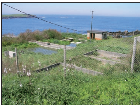
Figura 35. Balsas de decantación de la depuradora de Bañuques, inutilizadas y colmadas de aguas fecales.
